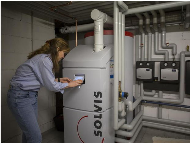
Gebäudeenergieberater/in (227686) Die Einstellungen an einem Hybrid-Heizsystem überprüfen
